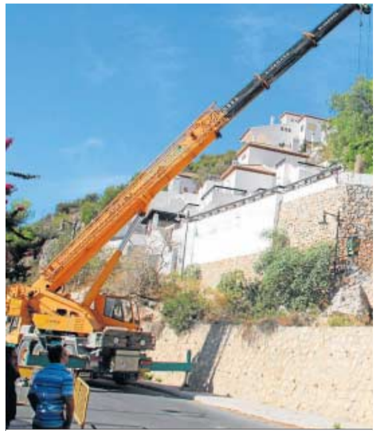
La urbanización ha sufrido numerosos corrimientos de tierra.
